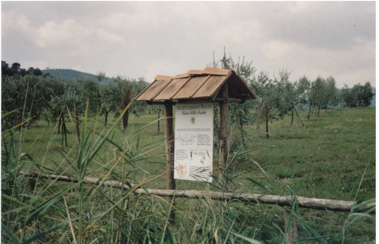
Foto 4 Pannello didattico illustrante le caratteristiche dell'impianto di fitodepurazione (archivio Ing. Ambientale Ilaria Baldi).
