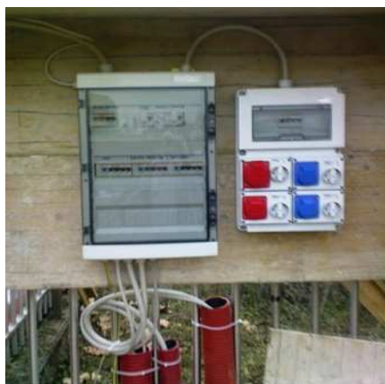
Esempio di quadro ASC e sotto-quadro idonei all'uso di cantiere
